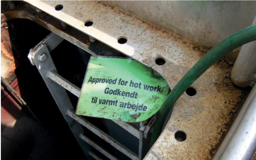
Tanken er godkendt til varmt arbejde.
