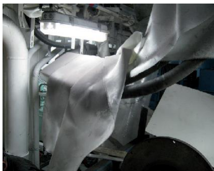
Beskyttelse mod gnister fra varmt arbejde.
